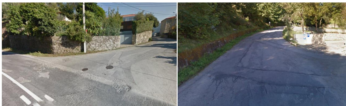
Figura 4. Exemplificação da degradação das vias existentes na ARU de Rio Caldo
