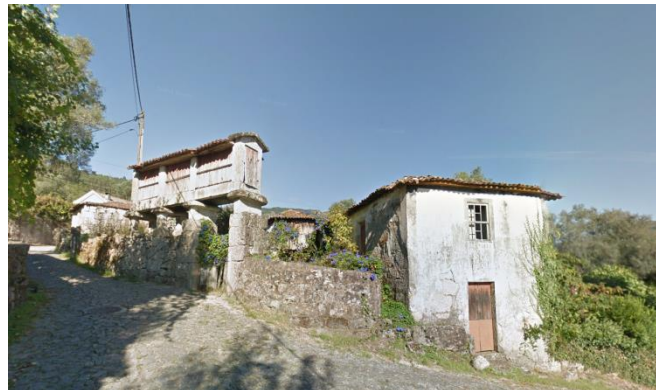
Figura 3. Edifício devoluto e bastante degradado junto da Igreja de Rio Caldo
